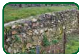
Exemple de mur de soutènement traditionnel, réalisé en moellons de meulière locale.
