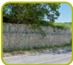
Gabions réalisés en moellon de craie, visibles sur la commune de Fleury-la-Rivière. (© PNR de la Montagne de Reims)
